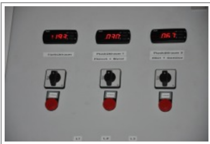
Übersichtliche Temperaturkontrolle der Kühlräume
