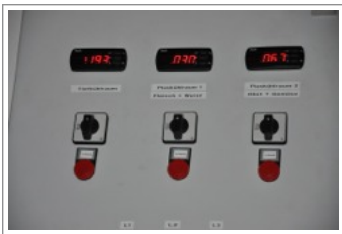
Übersichtliche Temperaturkontrolle der Kühlräume
