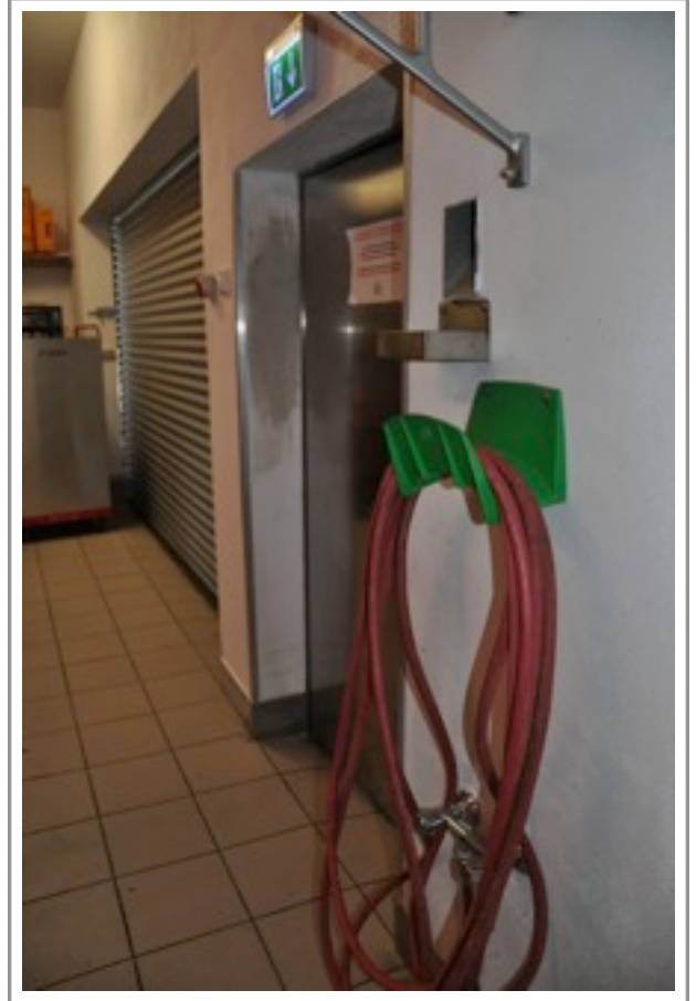
Direkte Möglichkeit zur Fahrzeugwäsche im Verladebereich sowie Stromanschlüsse zur Fahrzeugvorkühlung bei extremen Außen-Temperaturen
