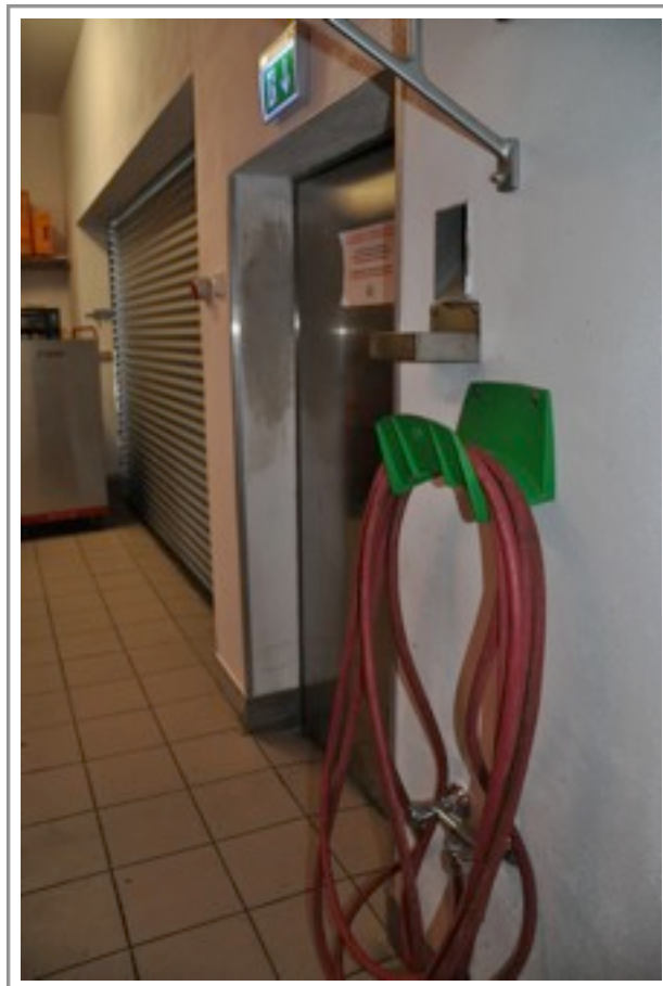
Direkte Möglichkeit zur Fahrzeugwäsche im Verladebereich sowie Stromanschlüsse zur Fahrzeugvorkühlung bei extremen Außen-Temperaturen
