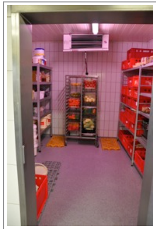
Modernste, getrennte Kühlräume mit Edelstahlausstattung und fugenlosen Böden zur optimalen Reinigung und Hygiene
