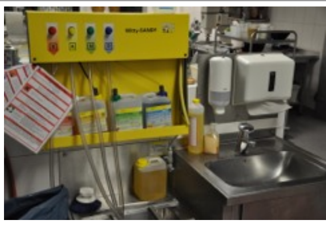
Hygienestation für standardmäßig dosierte Reinigungsarbeiten. Wasch- und Desinfizierstation für Personalhygiene
